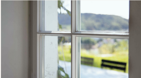
Mastic de fenêtres amianté
