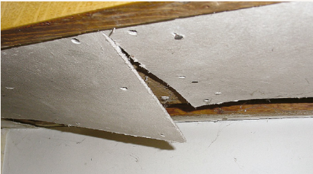
Panneaux légers amiantés (p. ex. revêtement ignifuge)
